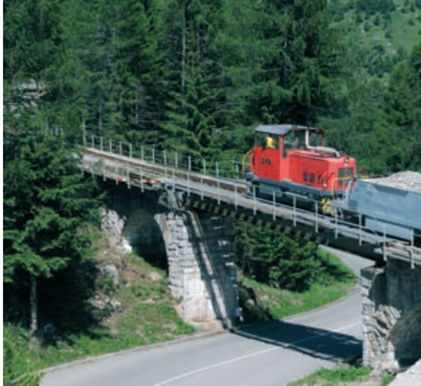
links: Rhoneviadukt unterhalb Gletsch (vor Sanierung).
