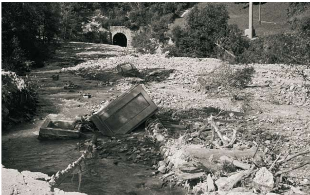
Von der Gleisanlage im und vor dem Plaunca-Tunnel ist nach dem Hochwasser von 1987 fast nichts mehr zu erkennen.
